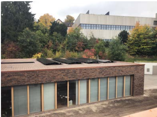
PV-Anlage auf Bürotrakt
