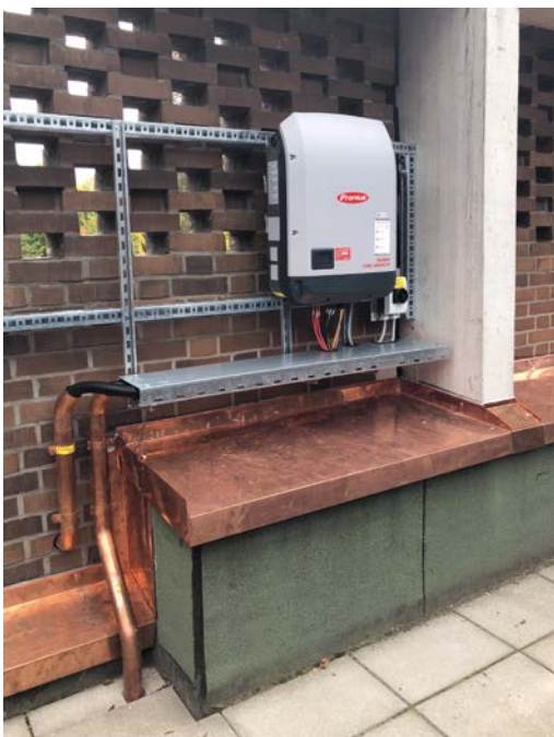
Wechselrichter der PV-Anlage
