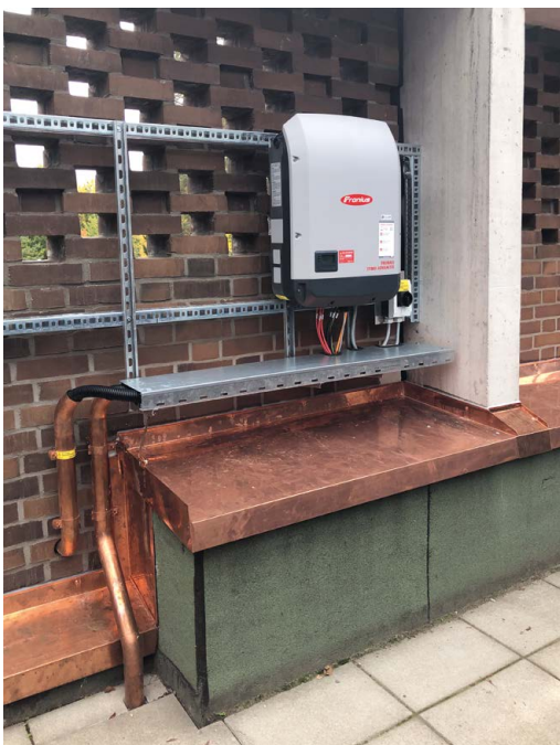
Wechselrichter der PV-Anlage
